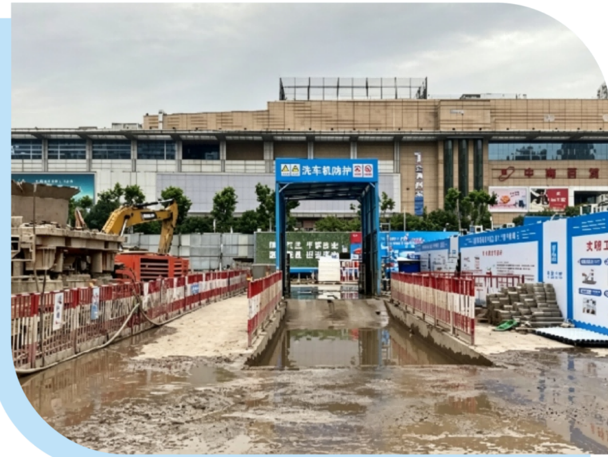
车辆冲洗设施 阿里巴巴华中总部项目
