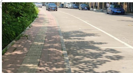
北侧未安装卧石
