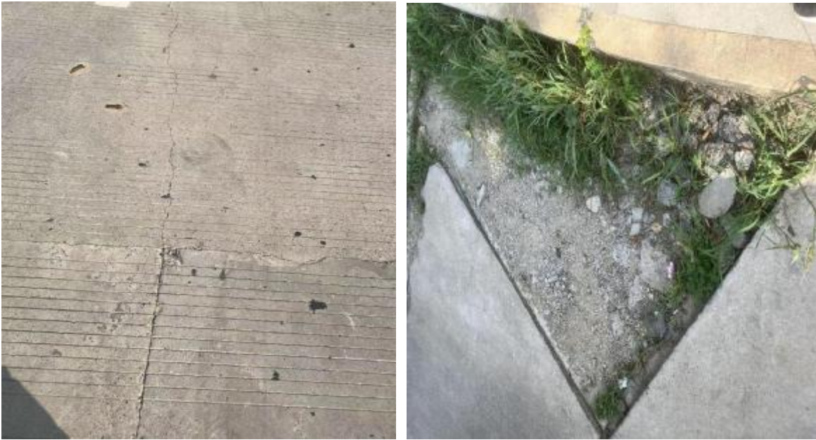
图 3.1 体育馆路现状病害
